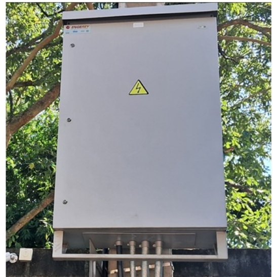
Foto 8 – PAINEL DE COMANDO ELÉTRICO
