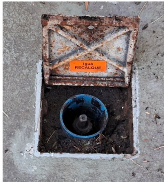
Foto 6 – Vista do interior da caixa do registro no recalque. Nota-se pintura deteriorada.
