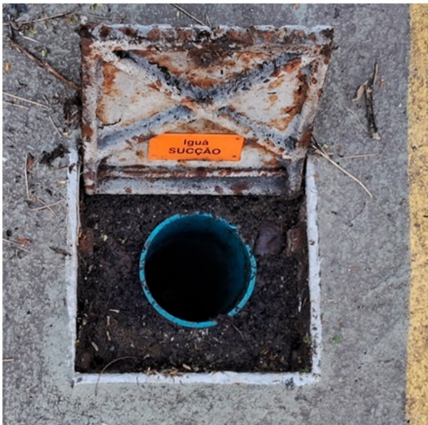
Foto 5 – Vista do interior da caixa do registro na sucção. Nota-se pintura deteriorada.
