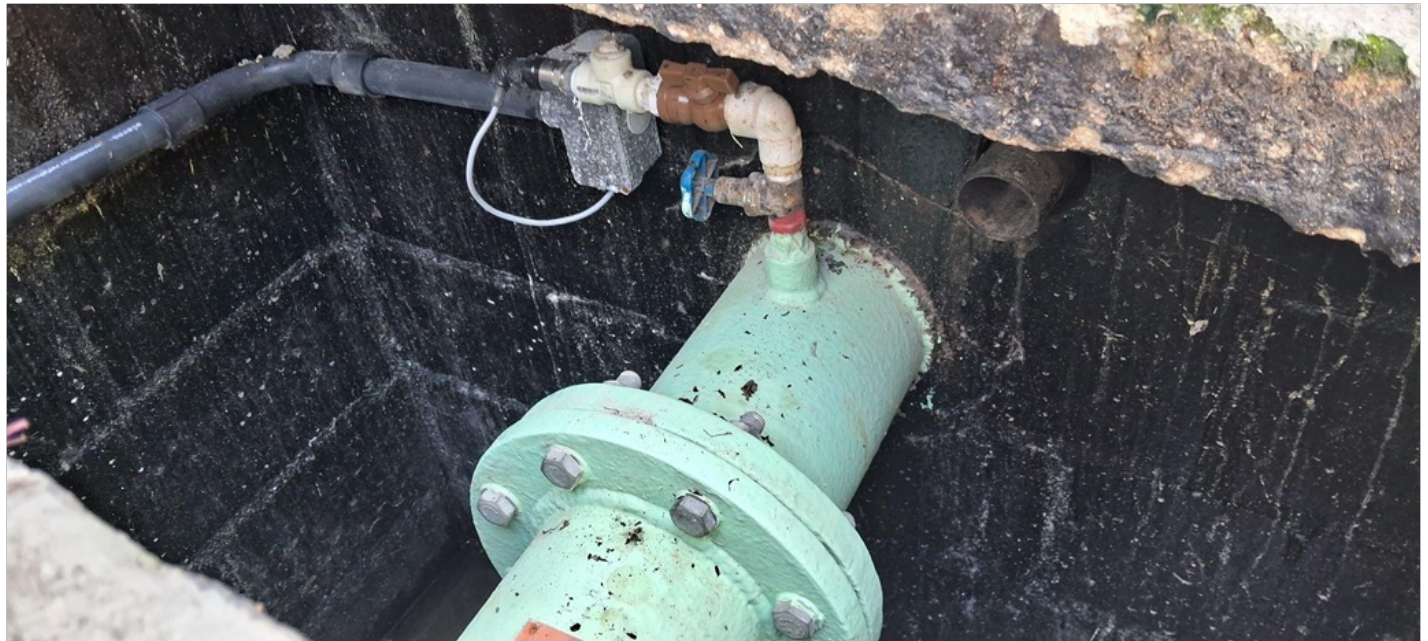
Foto 4 – Tubulação de recalque, que possui sensores eletrônicos de monitoramento. Nota-se ausência de válvula de retenção.
